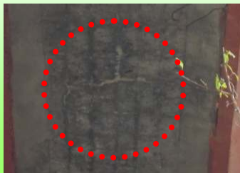
床版の損傷（ひびわれ）
