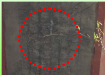
床版の損傷（ひびわれ）
