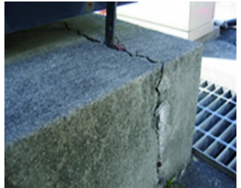
基礎部(基礎のクラック)
